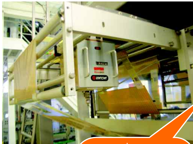
Instalace tiskárny Jaguar
